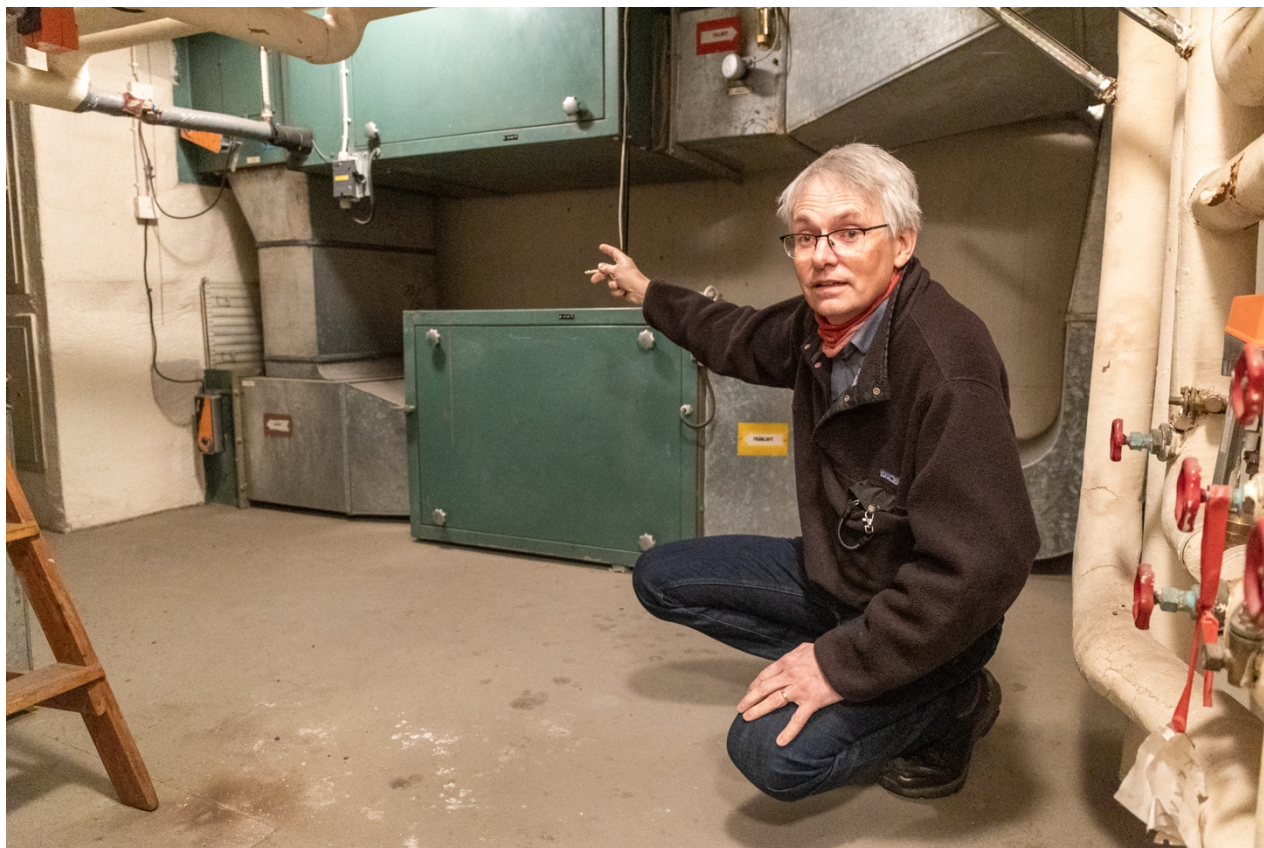
Dag Lundén visar ventilationskanaler i källaren, 21 apr
